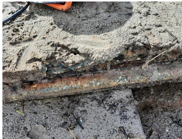
Figuur 5.8: beschadigde damplank
