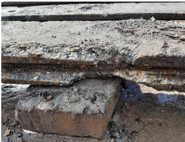
Figuur 5.9: beschadigde damplank
