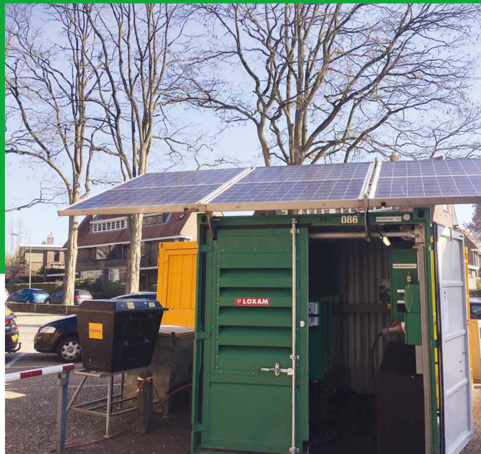
In het bestek stelde Arnhem extra duurzaamheidseisen. Dieselgeneratoren maakten plaats voor elektrische aggregaten op zonne-energie.
