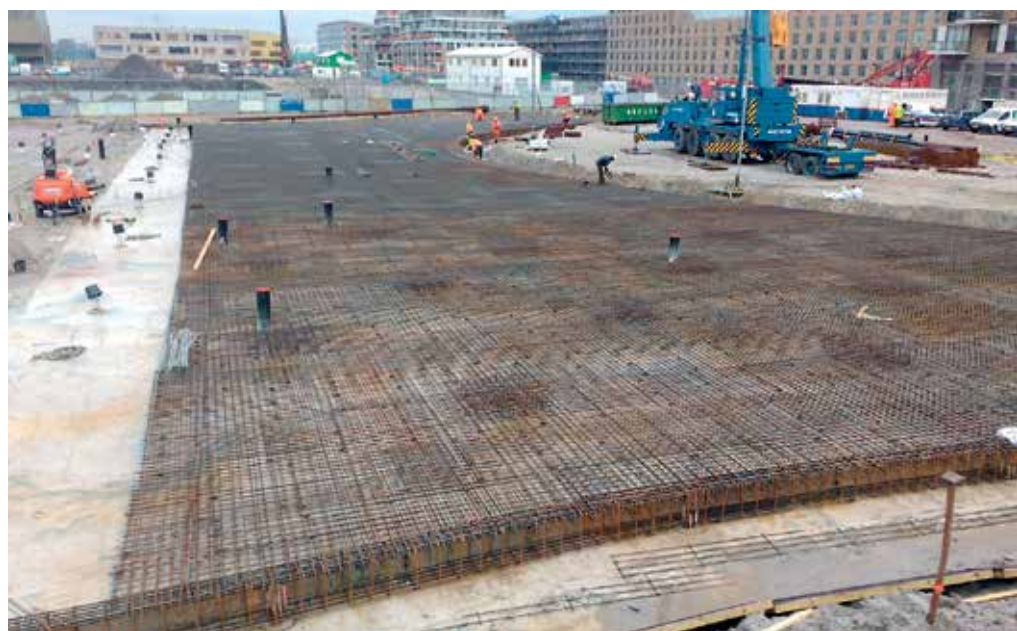
"Het skatepark staat op heipalen en de fundering is doorgerekend op een te dragen belasting," aldus projectleider Stanley van Peenen .
