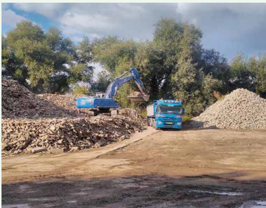
Gemeentelijk betonrecyclingdepot in Helmond.
